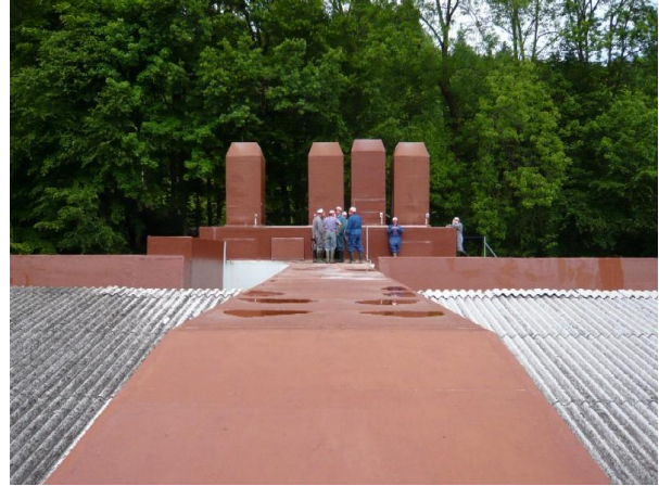
Abb. 4: Luftwäscher: Tribut an die Besiedlungsdichte
