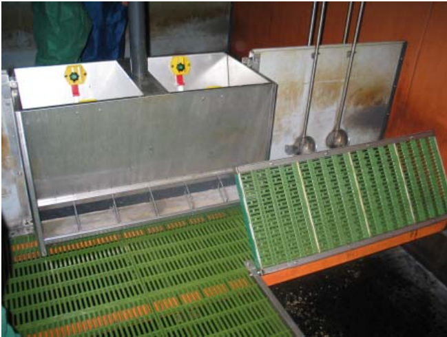
Abbildung 7: Luke im Flatdeck für Reinigungsarbeiten im Güllebereich
