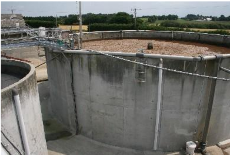
Abb.1: Güllebehälter mit Rührwerk und Belüftungseinrichtung
