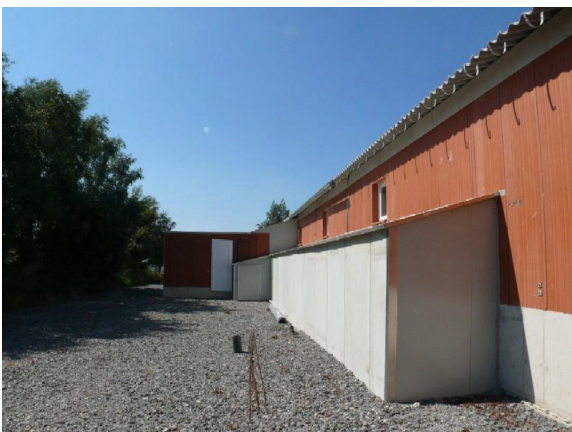
Abb.17: außenliegender Zentralabluftkanal mit Abluftwäscher im Hintergrund
