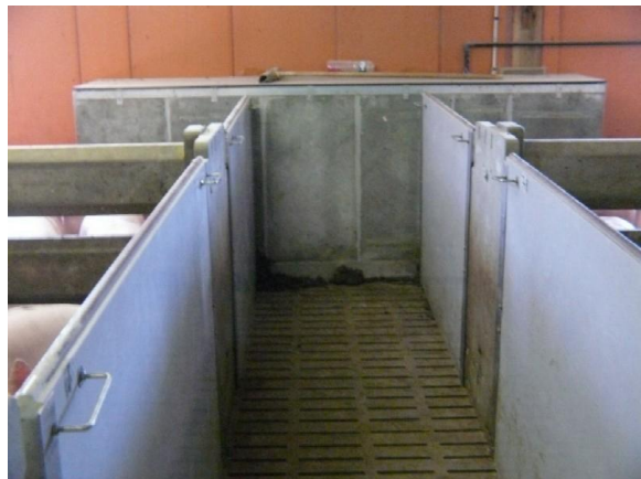
Abb.10: Unterflurzuluft mit Unterflurabsaugung im Maststall
