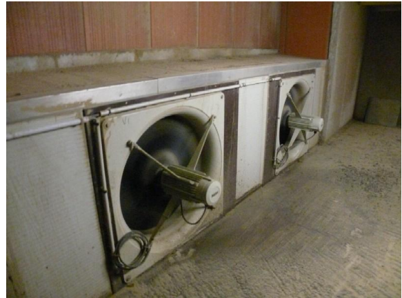
Abb.16: zentrale Lüfter für Unterflurabsaugung
