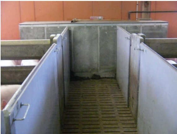
Abb.15: zentrale Unterflurabsaugung und -zuluft
