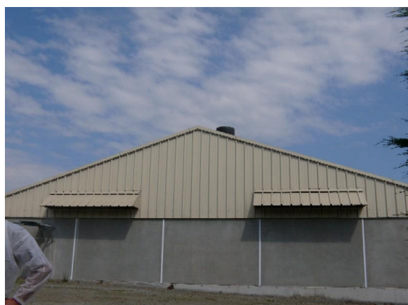
Abb.12: Windabweiser zur Verhinderung von Winddruck im Zuluftsystem
