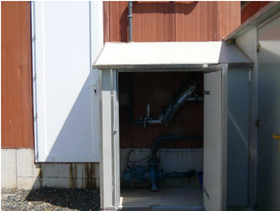
Abb.19: Blick in den Pumpenraum des Luftwäschers
